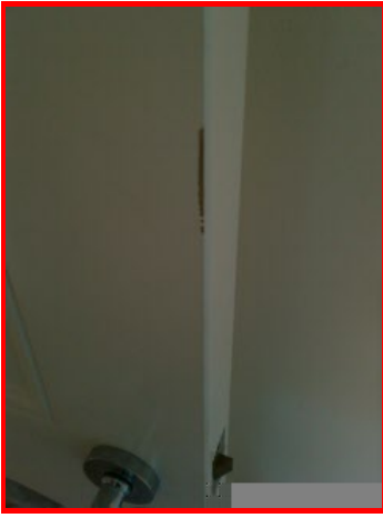
Bedroom 2 Door Door finish - chipped (above handle)
